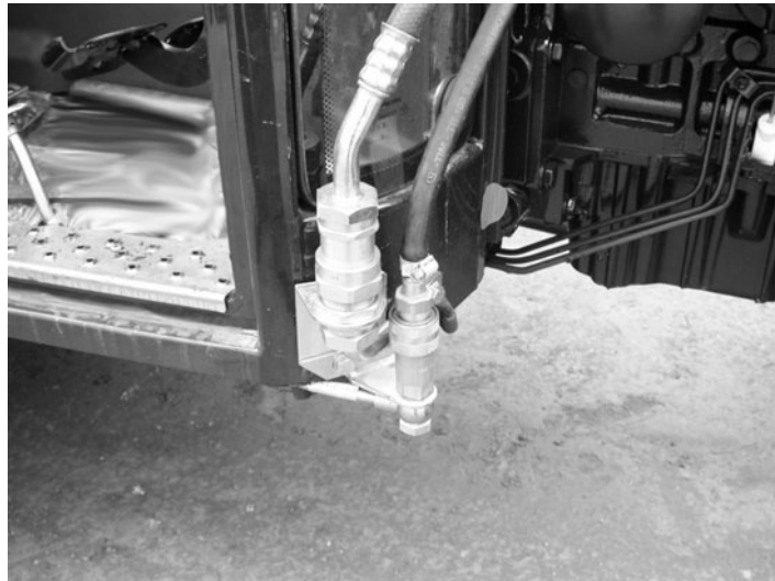
Clapets ou soupapes pour la recharge et l'entretien de l'installation du conditionnement d'air
